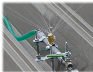
屋上に散水機設置
