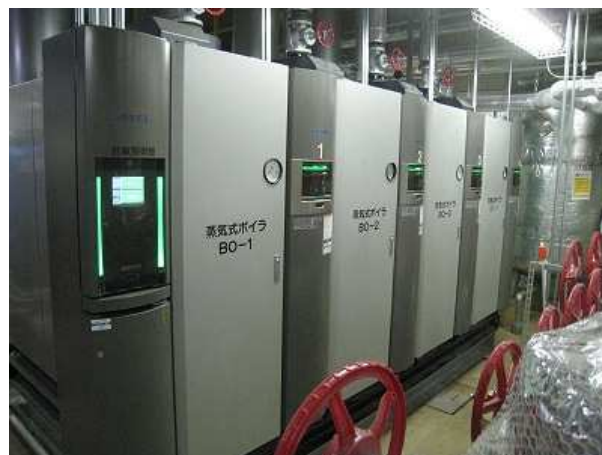
富山工場 LPG ボイラー
